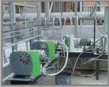
■ Wasseraufbereitung - Dosieren und Mischen von Kalk
